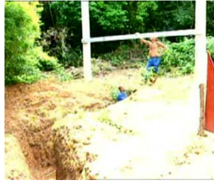
ขั้นตอนที่ 2 ขุดร่องเป็นรูปตัว S ซึ่งจะช่วยให้ได้สายเคเบิลใต้น้ำยาวขึ้น เพื่อสำรองในการติดตั้งสายเคเบิลใต้น้ำกับ จุดขึ้น-ลง
