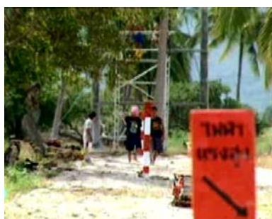
ขั้นตอนที่ 12 ทำเครื่องหมายแสดงว่ามีสายไฟฟ้าแรงสูงฝังอยู่ในบริเวณ จุดขึ้น-ลง ที่ติดตั้งสายเคเบิลใต้น้ำและสภาพพื้นที่มีการฝังกลบสายเคเบิลใต้น้ำเรียบร้อยแล้ว
