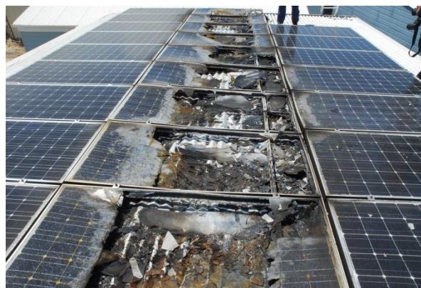
รูปที่ 3-2 ตัวอย่างแผงเซลล์แสงอาทิตย์เกิดเหตุไฟไหม้หน้าแผง
