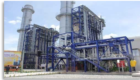
โรงไฟฟ้าวังน้อย
