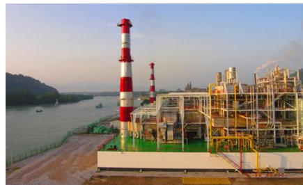
โรงไฟฟ้าพนม
