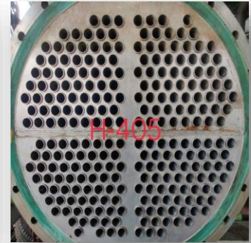
รูป ครอบสกปรกอุดตันในเครื่อง Condenser หลังปรับปรุง
