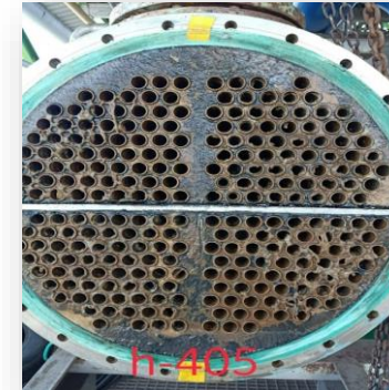
รูป ครอบสกปรกอุดตันในเครื่อง Condenser ก่อนปรับปรุง
